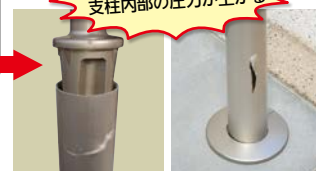
支柱の上部や下部が破損してしまいます。
